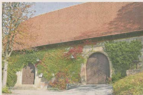
Das Weinbaumuseum wird derzeit aufwendig saniert. Die frühere Zehntscheuer des Deutschen Ordens wurde 1574 erbaut.
